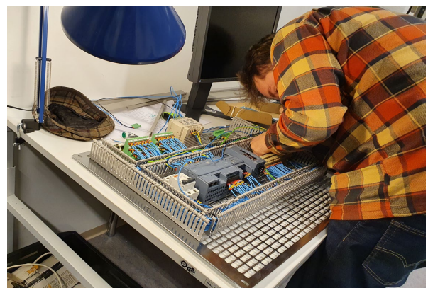
Kuva 2. Uuden ohjauslogiikan asennus asennuslevylle.
