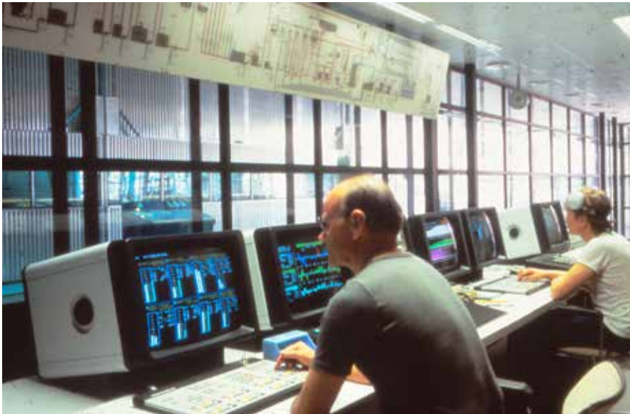
Valmetin Damatic-järjestelmällä toteutettu valvomo 1970-luvulta.
