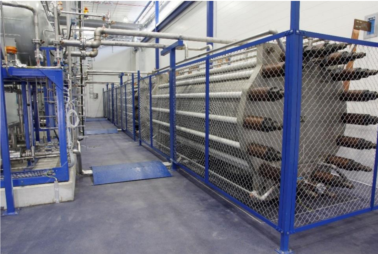
Kuva. 3x3 MW alkali vedenelektrolyseri (AWE).
