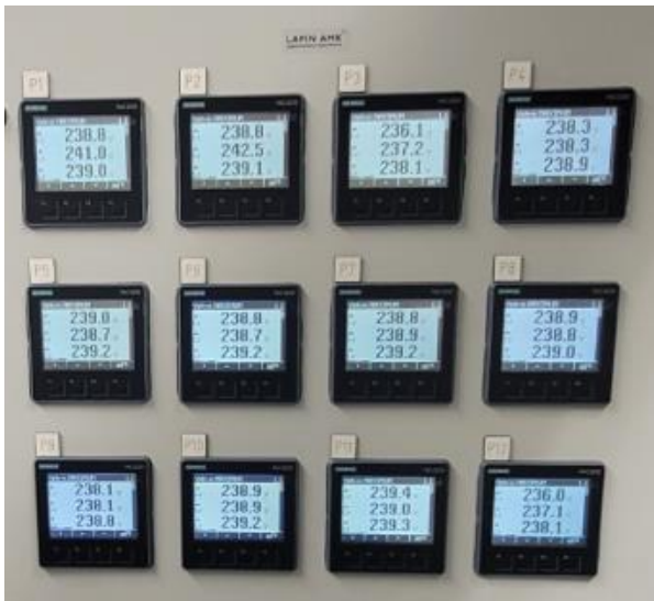
Kuva 8. Sähkön mittauksia Sentron PAC3220-laitteilla
